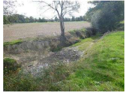
Erosion de berge sur le Marians à Grenade-sur-Adour
