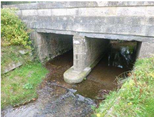
Radier de pont avec hauteur d'eau limitante sur le Moulin de Bordes à Souprosse
