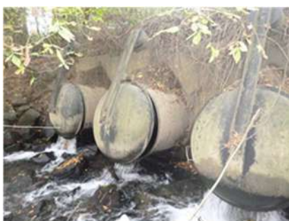
Porte anti-flots sur le ruisseau du Martinet
