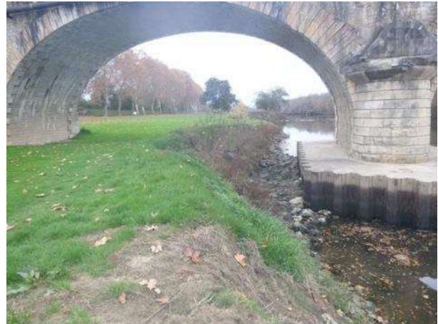
Erosion de berge sur l'Adour à Dax
