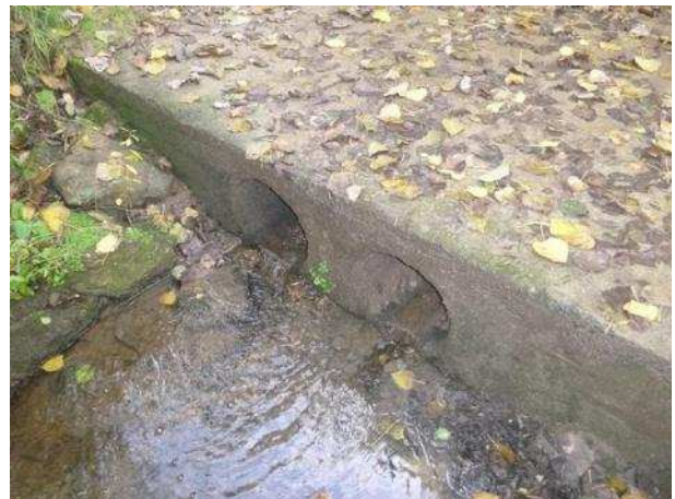
Passage busé difficilement franchissable sur le Laguibaou à Castandet
