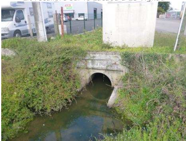
Lit busé sur le ruisseau de Péré à Saint-Sever
